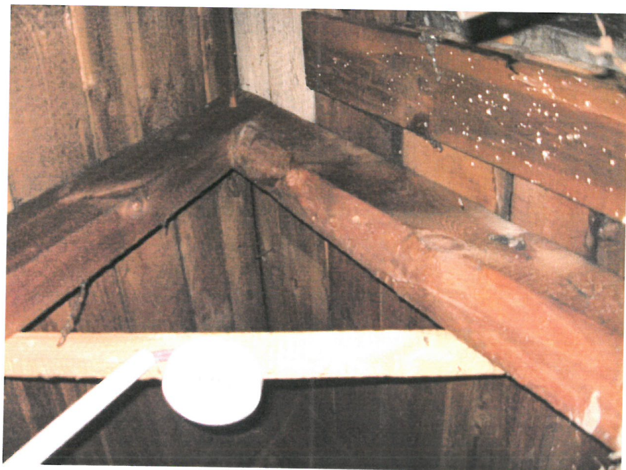
Fot. 2 Widoczna górna jętka o przekroju 12/2,5 cm występująca co drugi wiązar.
