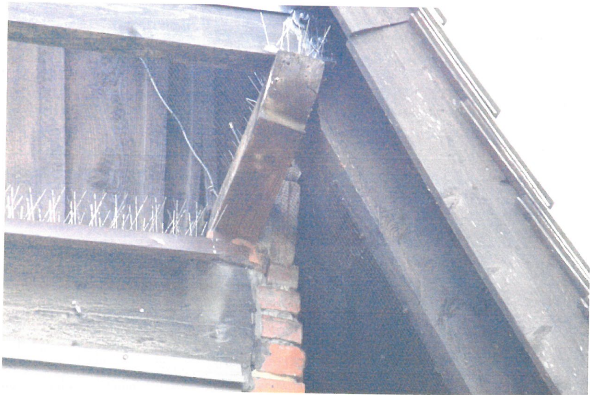
Fot. 6 Elewacja zachodnia – prawa murłata skręcona w prawo i śladami korozji biologicznej.
