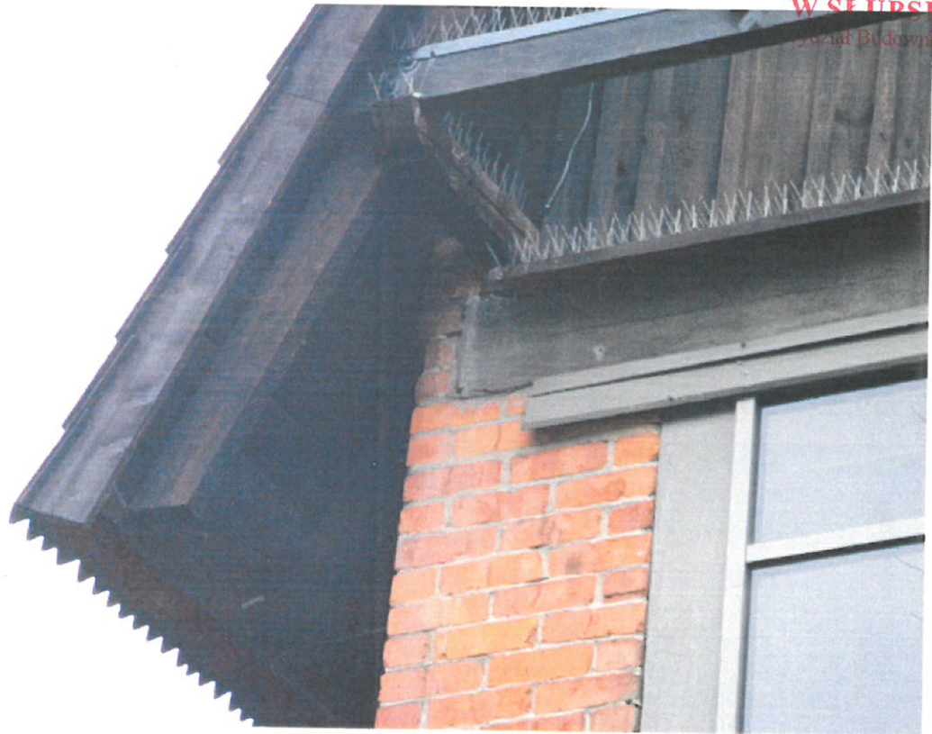
Fot. 5 Elewacja zachodnia – lewa murłata z podłużnym rozwarstwieniem i śladami korozji biologicznej.
