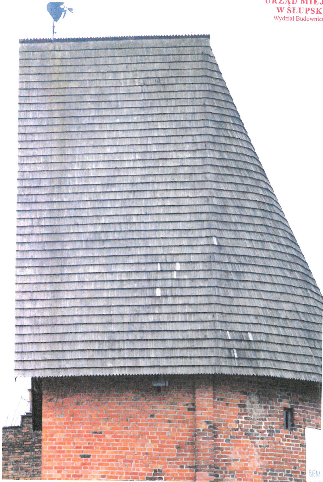
Fot. 7 Połacie dachowa południowa ze śladami wymiany pojedynczych gontów. W piątym i szóstym rzędzie uszkodzone gonty (zmurszałe z ubytkami).
