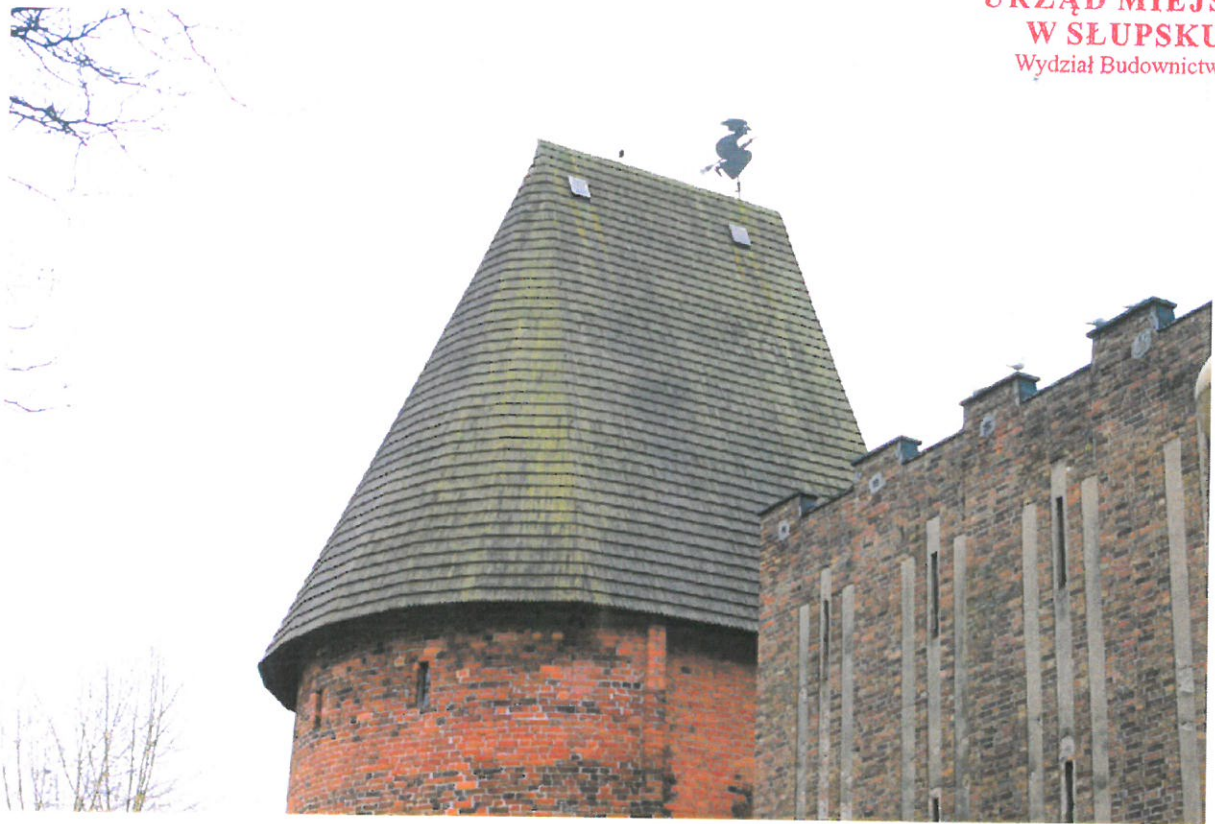
Fot. 8 Połac dachowa północna – gonty pokryte porostami utrzymującymi wilgoć, co przyczynia się do korozji biologicznej.
