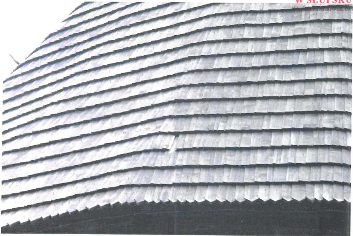
Fot. 12. Połąc dachowa wschodnia – widoczny ubytek gontu w czwartym rzędzie od okapu.
